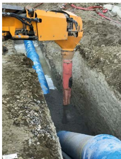
Nach der Druckprobe wird die Leitung mit einer 30-60 cm dicken Betonschicht überdeckt...
