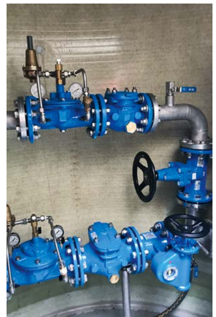
Einblick in das Schachtinnere mit den Druckreduzierventilen DVF und Hochdruckarmaturen von Erhard.
