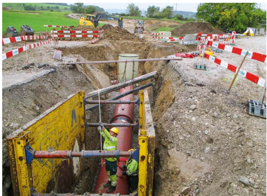
Abwasserleitungen aus Guss-Kanalrohren von Duktus/Hagenbucher, versehen mit einer Zementmörtel-Aussenbeschichtung (FZM-BRS).
